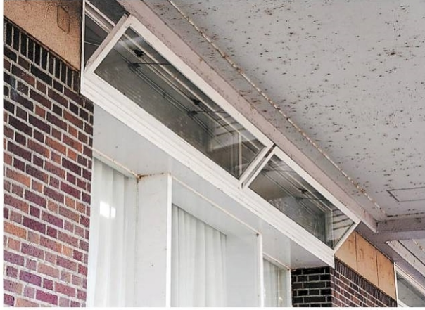
兵庫県宝塚市役所に設置された排煙窓
